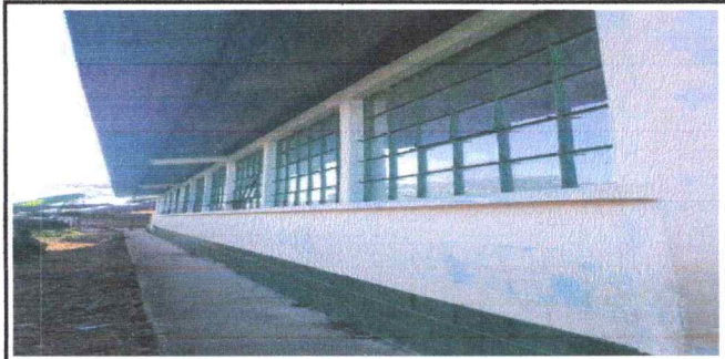
Se observa la falta de balcones en la parte trancera del establecimiento
